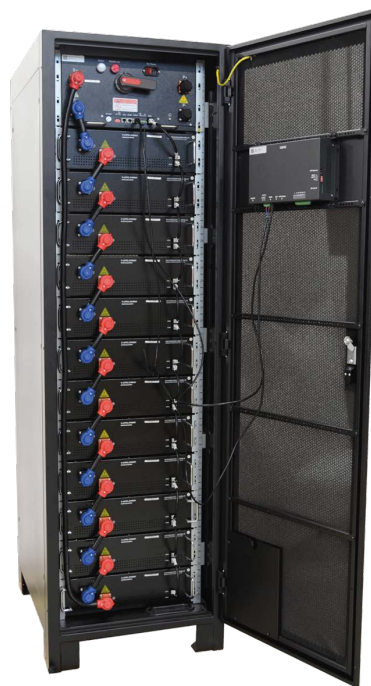
Кабинет LP с батарейными модулями
