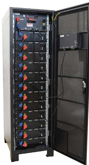
Кабинет LP с батарейными модулями
