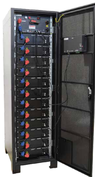
Кабинет LP с батарейными модулями
