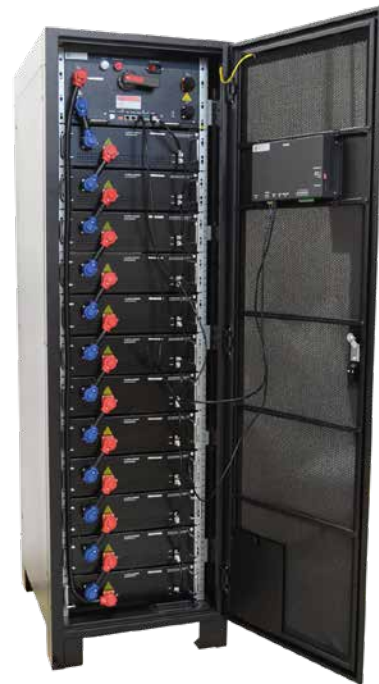
Кабинет LP с батарейными модулями
