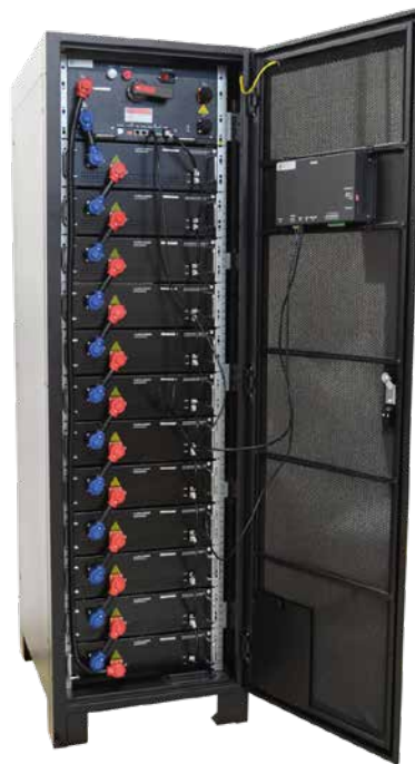
Кабинет LP с батарейными модулями
