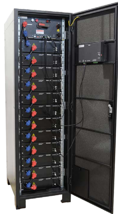
Кабинет LP с батарейными модулями
