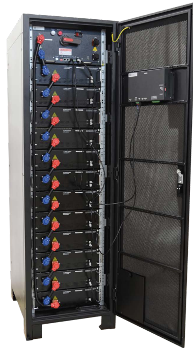
Кабинет LP с батарейными модулями
