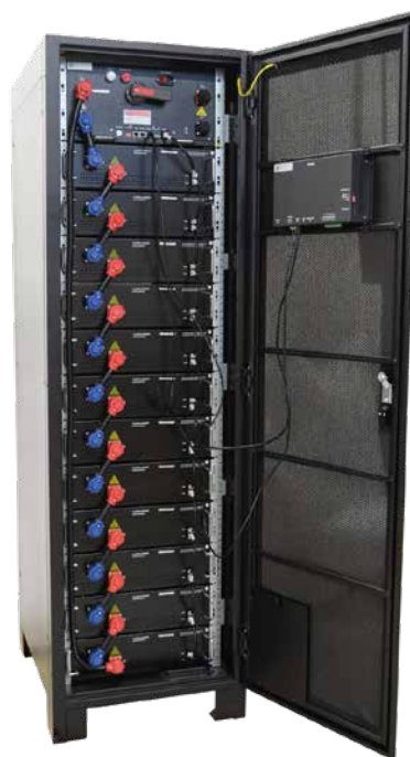
Кабинет LP с батарейными модулями
