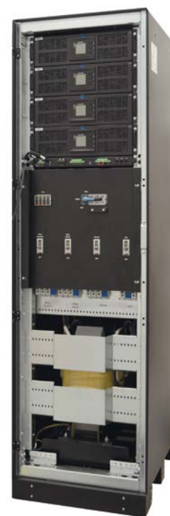
АБП 80 кВА с 4 силовыми модулями и изолирующим трансформатором
